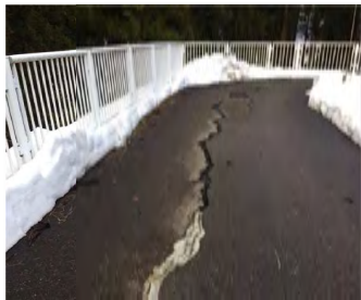
▼地震による亀裂
