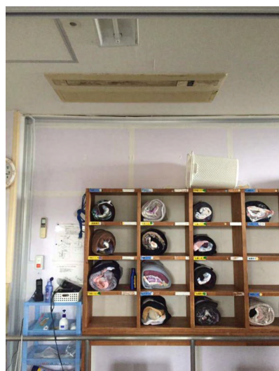
▼浴室の空調設備
