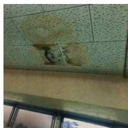
▼雨漏りしていた天井 (事務所前食堂)
