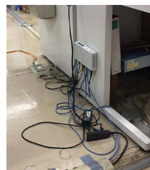
▼事務室の配線コード
