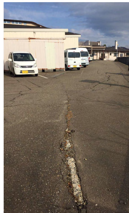
▼敷地内の通行路の亀裂
