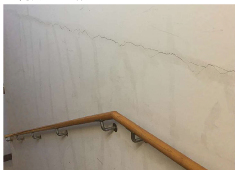
▼内装のひび割れ
