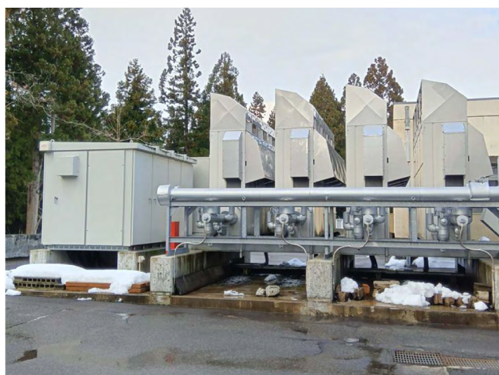
▼エコキュート設備
