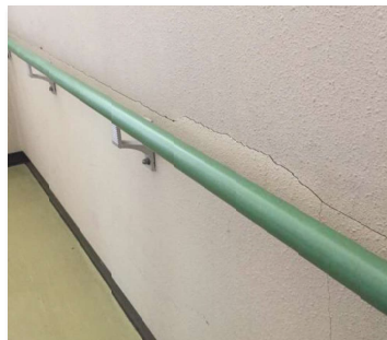
▼廊下のカベのひび割れ
