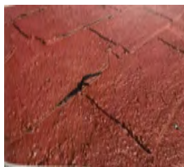
▼食堂の屋根部分 (めくれてしまった箇所)
