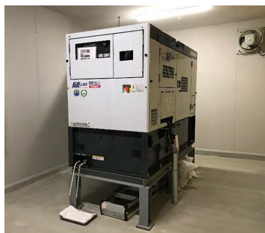
ディーゼルエンジン型発電機 (軽油, 50kVA)
